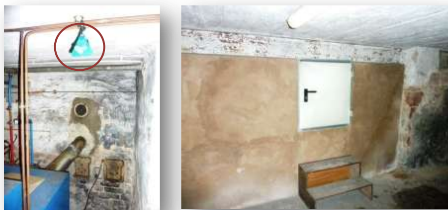
Photos 9 et 10 : Dispositif passif installé à proximité de la chaudière et compartiment fermé où se trouve la cuve à fioul.
