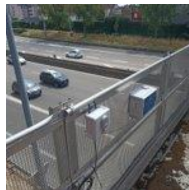
Microcapteur installé au niveau du portique (Source : ATMO Grand Est)
