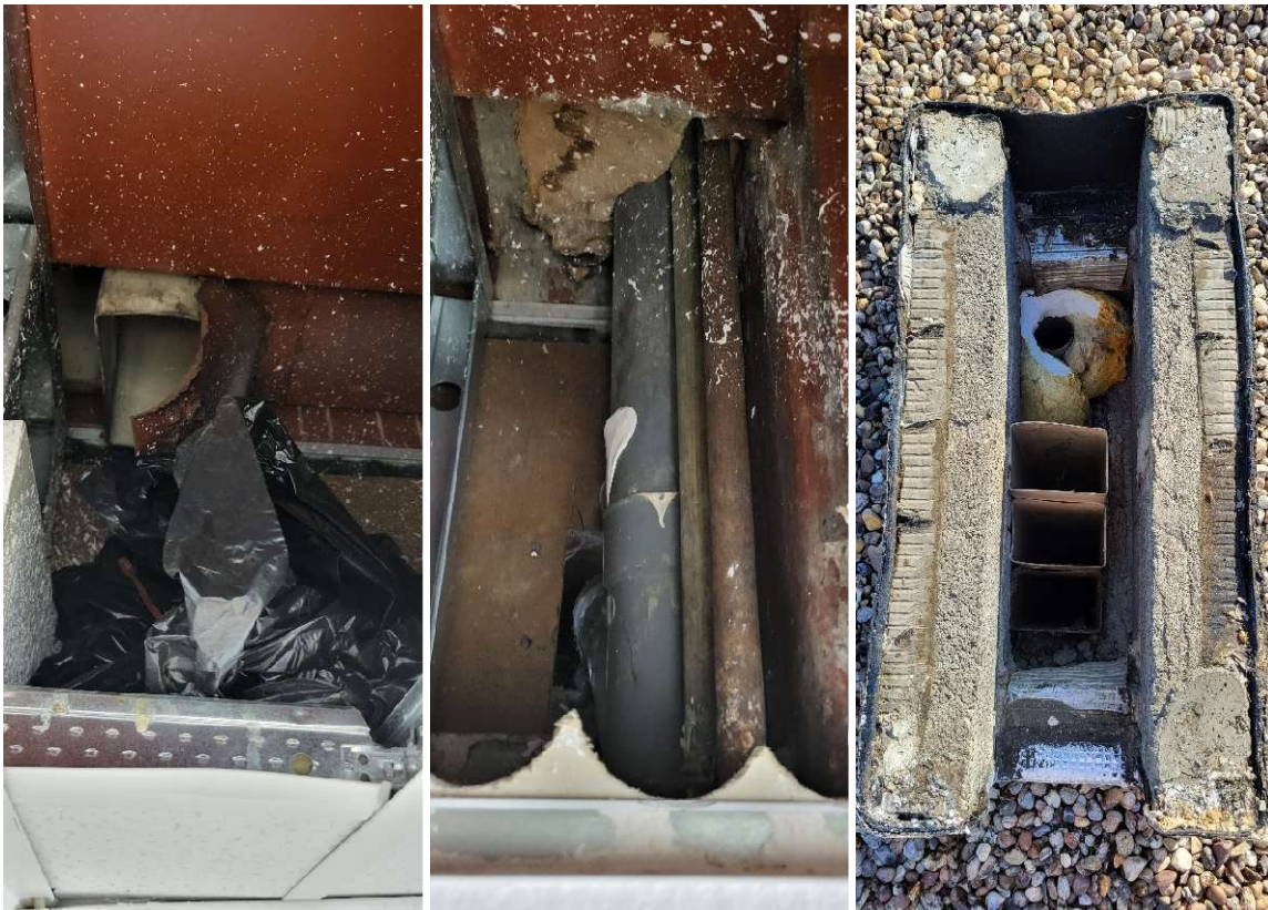
Figure 1 : Réseau de canalisation / aération traversant les salles investiguées pour les odeurs (avec vue en toiture)
