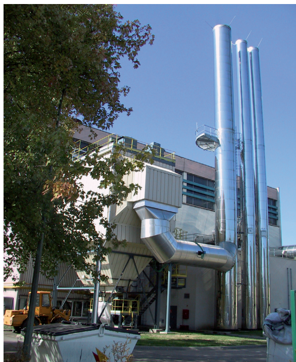
Chaufferie collective sur Strasbourg ayant fait l'objet d'une réduction supplémentaire des rejets atmosphériques, Source photo: Dalkia
