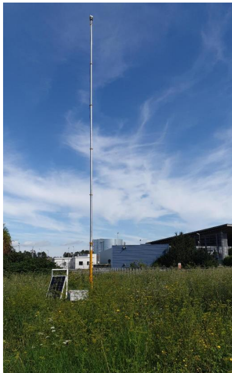
Figure 3 : Mât équipé d'une station météorologique installé sur le site d'AUREADE
