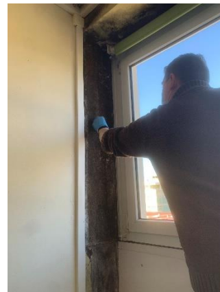
Figure 14 : Moisissures observées dans une salle de classe du lycée F
